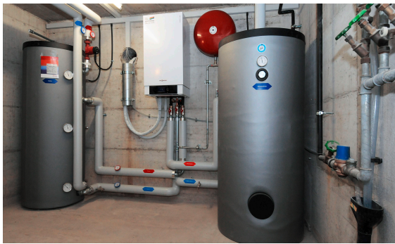
Die Split-Wärmepumpenanlage mit (v. l.) 300-Liter-Pufferspeicher, Vitocal 200-S-Inneneinheit, Expansionsgefäß für die Heizgruppe und 500-Liter-Warmwasserspeicher hat auf nur 6 m 2 Platz. (Fotos: Peter T. Klaentschi)
