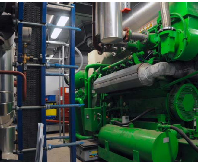
Das Blockheizkraftwerk produziert Strom für 800 bis 1000 Haushaltungen.
