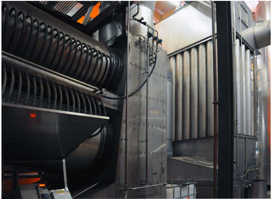
Blick auf den Rauchgaskondensator für die Wärmerückgewinnung (links) und den rechts davon platzierten Nasselektroabscheider.
